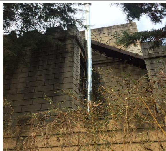
蒸汽发生器排气筒（9m）
