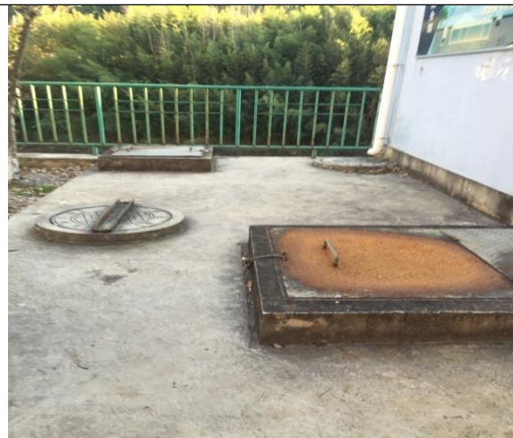
麦冲村污水处理站
