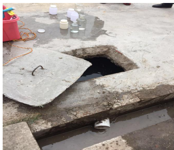
废水沉淀池（3m³）
